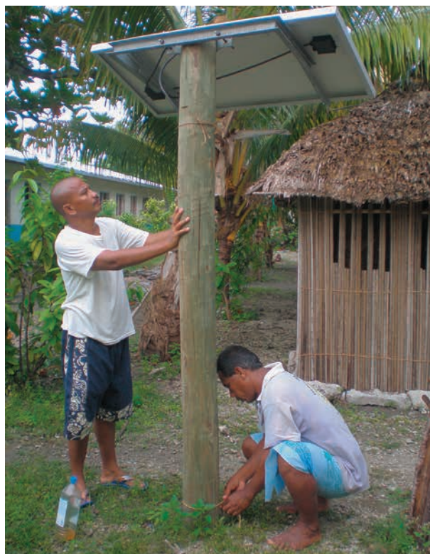
在太平洋岛屿区域安装光伏装置。
