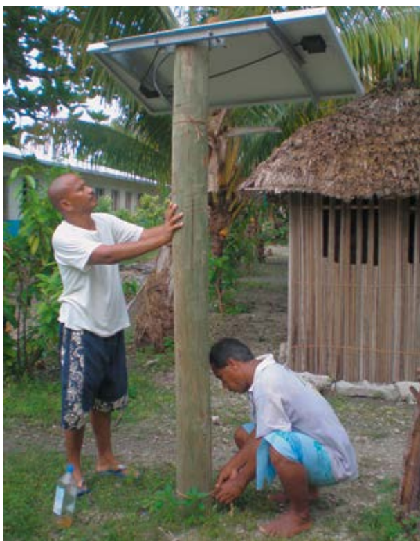
Instalación de unidades fotovoltaicas en la región de las islas del Pacífico.
