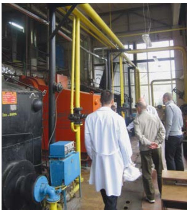
Instalación de intercambiadores de calor en una de las principales panaderías industriales de Ucrania.
