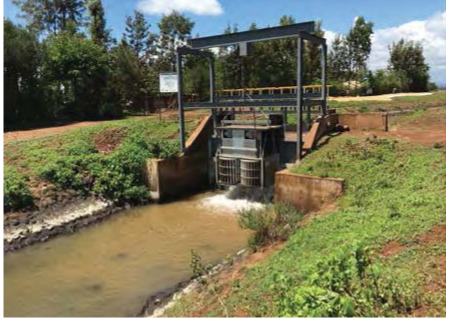
محطة للطاقة الكهرمائية الصغرى بمستوى سطح مياه بالغ الانخفاض في موبا، كينيا.
