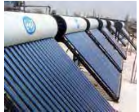
Système de chauffage solaire d'eau dans les tanneries au Bangladesh
