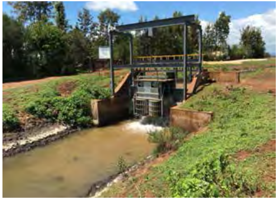
Installation de micro-hydroélectricité de très basse chute à Mwea au Kenya
