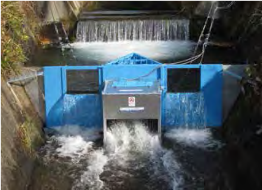
Installation de micro-hydroélectricité de très basse chute à Mwea au Kenya
