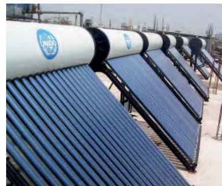
Солнечная водонагревательная система на кожевенных фабриках в Бангладеш.
