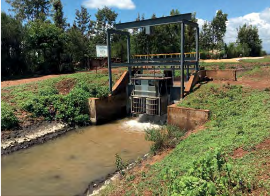
Сверхнизконапорная микрогидроэнергетическая установка в Мвеа, Кения.
