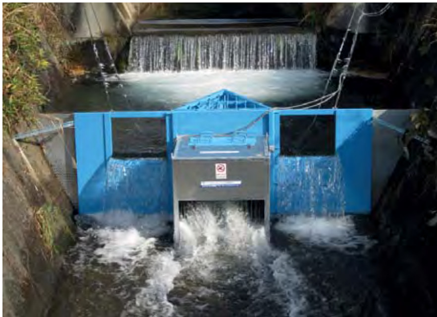
Сверхнизконапорная микрогидроэнергетическая установка в Мвеа, Кения.
