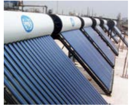
Sistema de calefacción del agua mediante energía solar en las curtidurías de Bangladesh.
