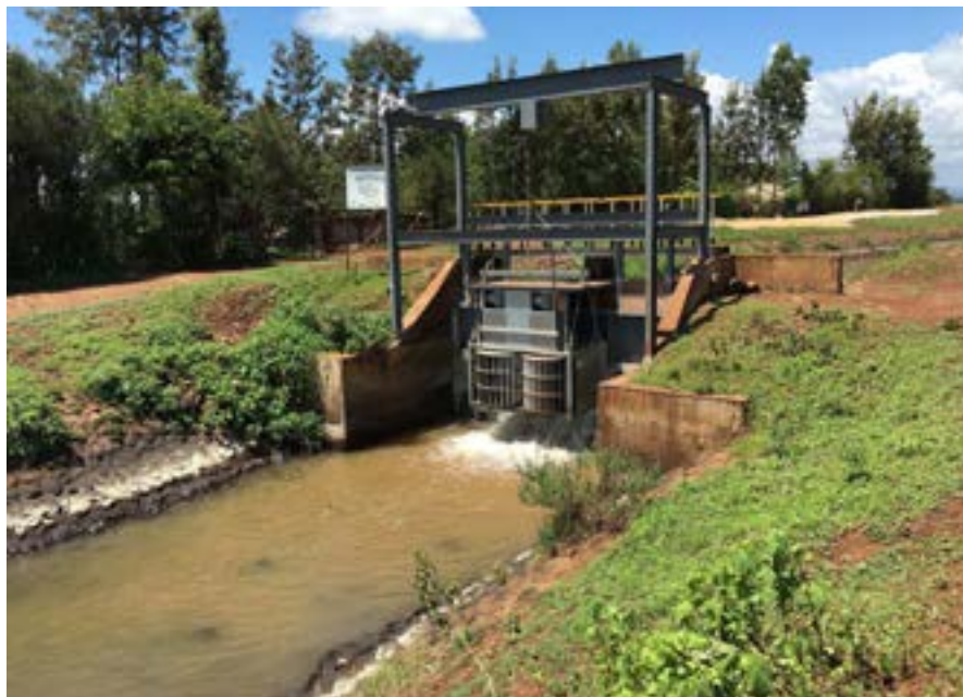
Microcentral hidroeléctrica de ultrabaja altura en Mwea, Kenia.
