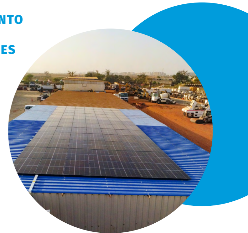
Paneles solares instalados en Eiffage Senegal
